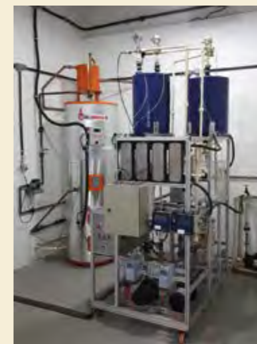
Figura 4. Detalhe da unidade demonstrativa de dessalinização via destilação por membranas do Laboratório de Tecnologias em Energias Sustentáveis, LATES-IPqM
